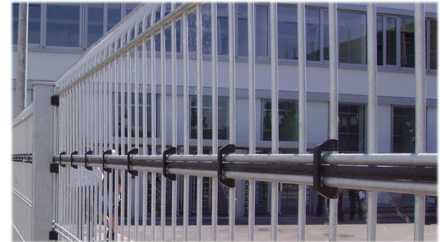
Eine aufgeräumte Kabelführung (Ansicht: nicht-Angriffsseite)
