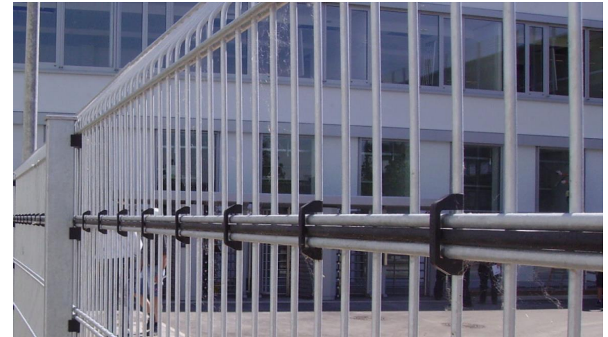
Eine aufgeräumte Kabelführung (Ansicht: nicht-Angriffsseite)
